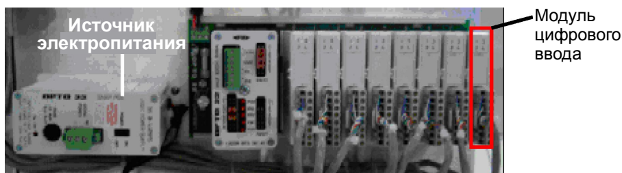
Рисунок 7-8: Контроллер элементного монитора
